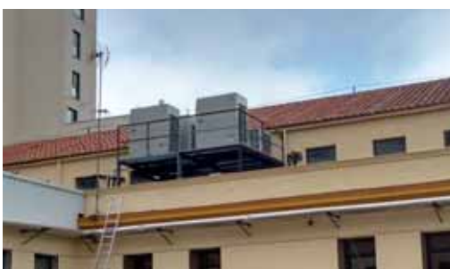
Residencia Mayores (Puertollano) Maxi MVD 2 tubos 156 kW
