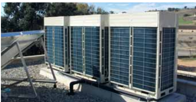
Nave de Catering Monzon (Huesca) Maxi MVD 2 tubos 105 kW
