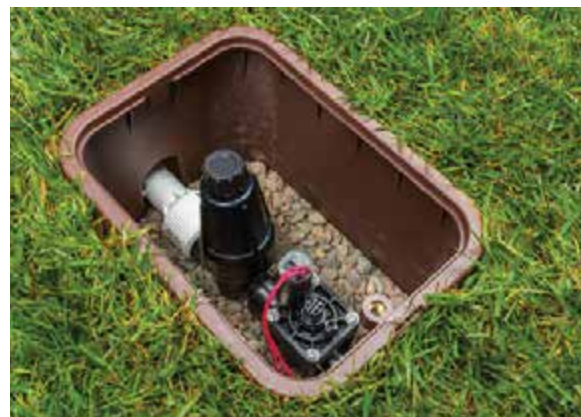
PCZ-101 instalado en una arqueta polivalente
