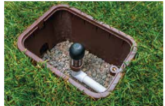
Válvula de ventosa de aire/vacío instalada
