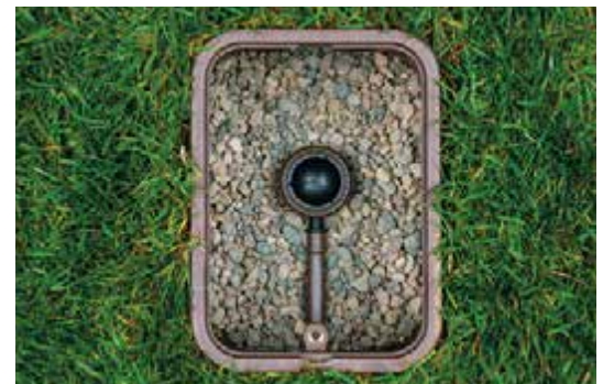
Válvula de descarga automática instalada
